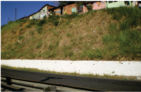
Figura 12: Encostas sujeitas a deslizamentos Fonte: Pesquisa de campo, 2007 Elaboração: André Gustavo P. dos Santos, 2007
